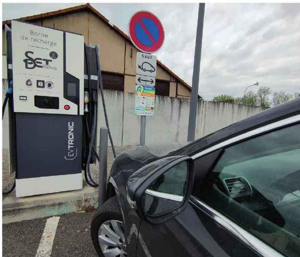
Une borne de recharge pour véhicules électriques installée à la gare multimodale de Carmaux. [Alexandre Renault/Le Tarn libre]
